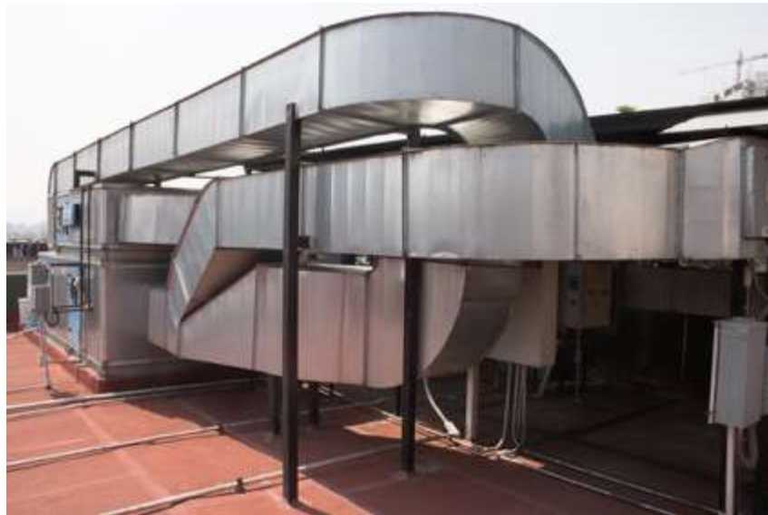
FIG. 115 Vista de la azotea con el complejo sistema de aire acondicionado y recirculación ambiental que opera para la Fototeca Nacho López y también para la mapoteca, fonoteca y otras instalaciones de preservación de acervos en la CDI.
