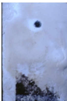
Baja magnificación del deterioro por hongo
