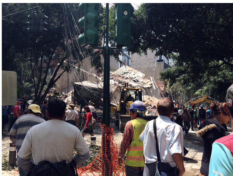
Edificio colapsado el 19 de septiembre de 2017 en la esquina de Amsterdam y Nuevo Laredo, colonia Roma, Ciudad de México. Foto: Valeria Vega
